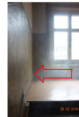
Ecke über Treppenpodest gegen Wohnung, Raucheintritt bei Überdruck in der Wohnung 2. OG
