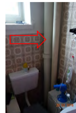
Ecke Bad gegen Treppenhaus, massiver Mauerwerkrisse hinter der Steigzone
