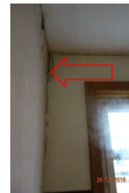
Ecke unter Treppenpodest gegen Wohnung, Raucheintritt bei Überdruck in der Wohnung 2. OG
